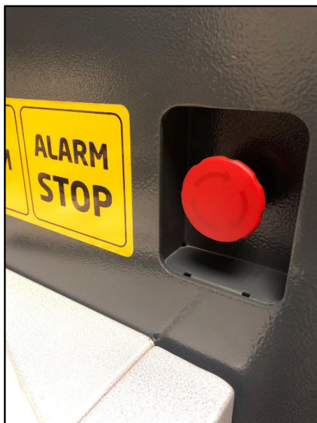
Рис. 31. Кнопка аварийной остановки на корпусе РТУ.
