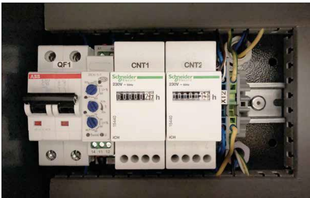
Рис. 33 Сервисный щиток, где
